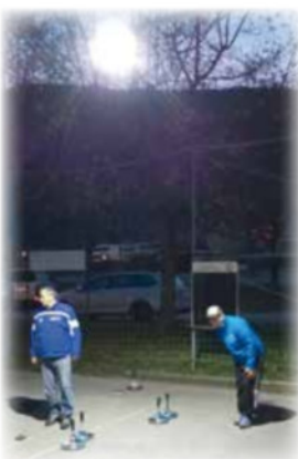
Neue LED Lichtanlage
